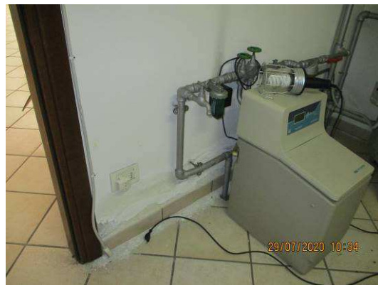
Particolare dei problemi di risalita umidità
