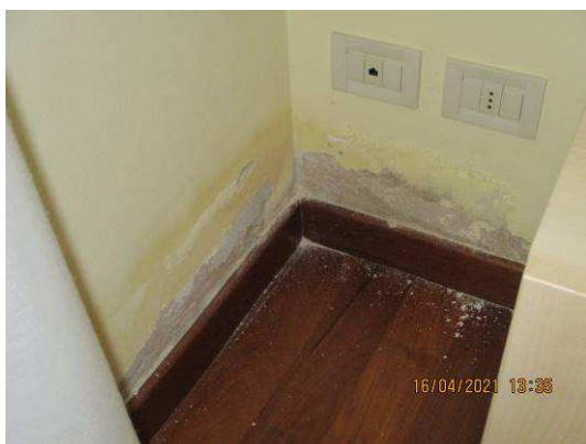
Particolare dei problemi di risalita umidità
