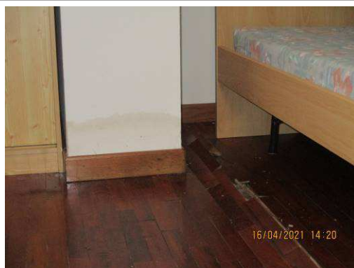
Problemi di infiltrazione e pavimento 2° ripostiglio
