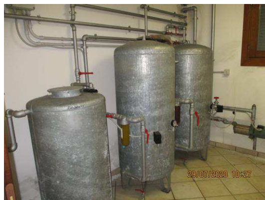
Cantina con apparecchiature per gestione piscina
