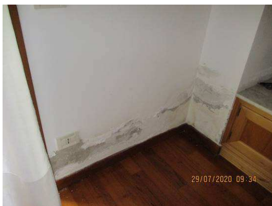
Particolare dei problemi di risalita umidità
