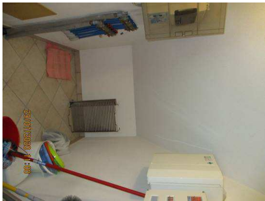
Ripostiglio con quadro elettrico
