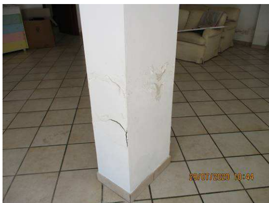
Particolare dei problemi di risalita umidità
